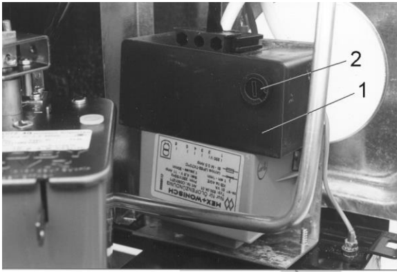
Abbildung 16: Zündtransformator 1 Zündtransformator 2 Schraubkappe mit Feinsicherung
