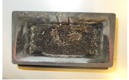
BEISPIEL VERSCHMUTZTE BRENNSCHALE
